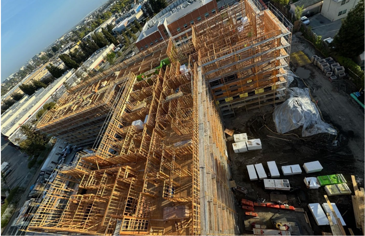
Figura 1 - Avance de la construcción en el edificio norte, abril de 2024. Este edificio está enmarcado hasta el quinto piso y se están instalando ventanas.
