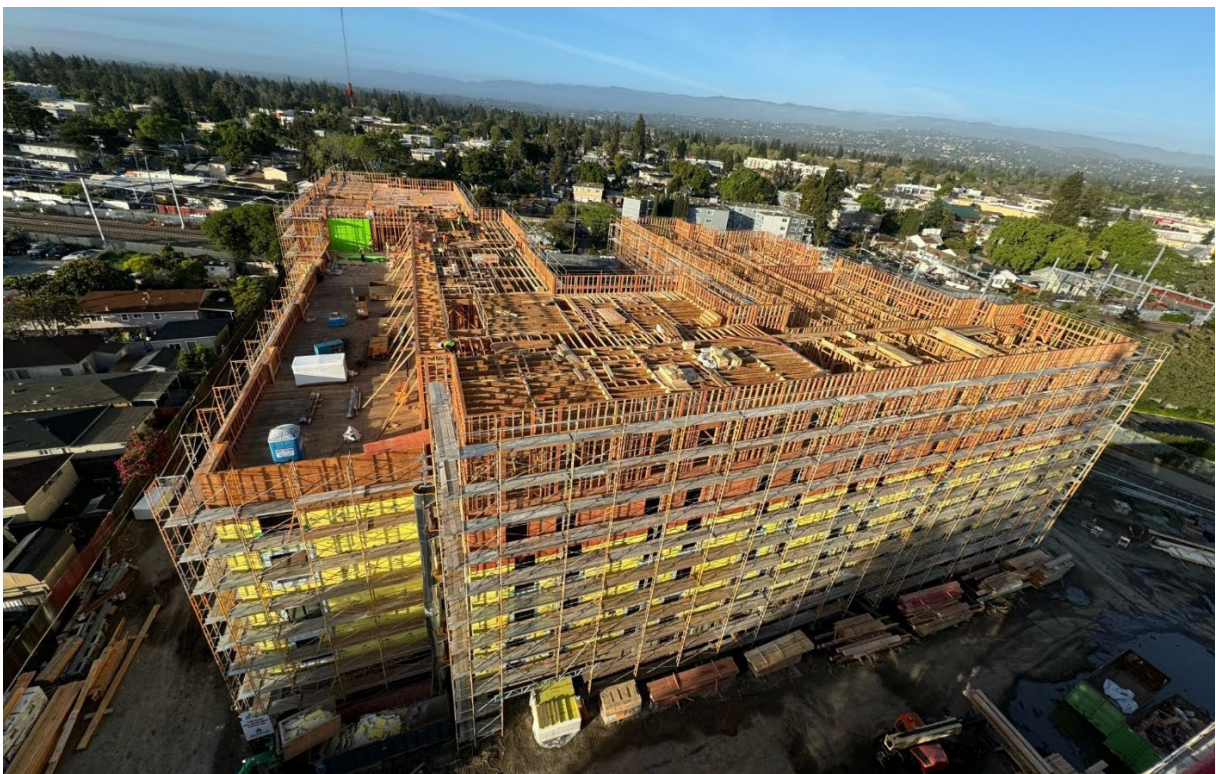
Figura 2 - Avance de la construcción del edificio sur a principios de abril de 2024. Este edificio está completamente enmarcado hasta el quinto piso. Se han instalado ventanas hasta el tercer piso. La estructura y el techo del sexto piso están en marcha.
